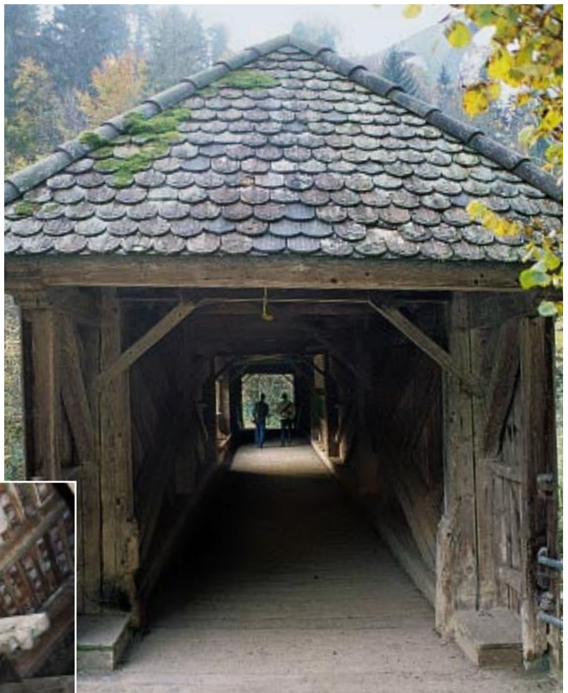
Brückenkopf der 30 m weit gespannten Brücke über die Urnäsch, Grubenmanns letzter Brücke
